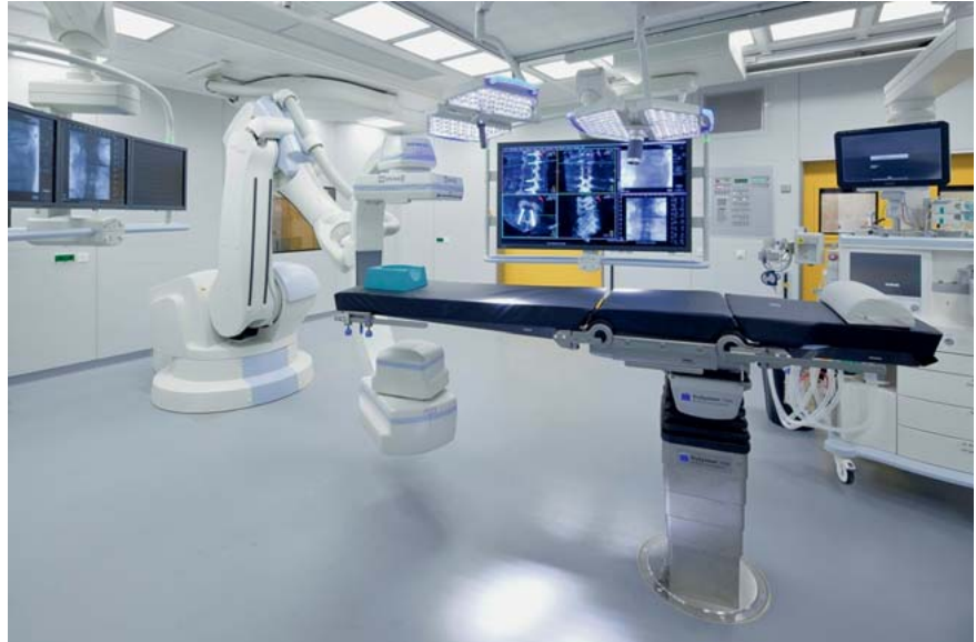
Abb. 13 Der Hybridoperationssaal (OP) verfügt über einen optimalen disziplinübergreifenden Aufbau. Zentrales Element dieses OPs ist das stationäre Bildgebungssystem mit dem integrierten Operationstisch.
