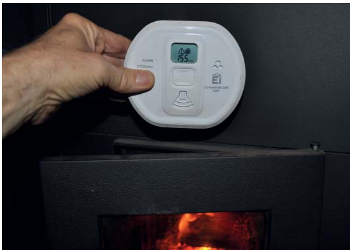
► Abb. 3 Beim Anfeuern lassen sich an der offenen Ofentür mit einem handelsüblichen CO-Warngerät kurzzeitig deutlich erhöhte CO-Konzentrationen nachweisen.
